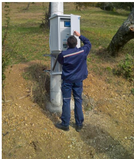
Slika 3. Izgled regulatora na stubu NN mreže
